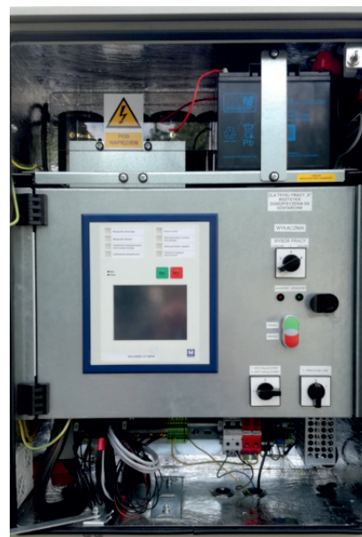
Rys. 7. Widok zespołu sterowniczego SRC-1 do nadzoru nad reklozorem THO-RC27 - sterownik SO-54SR-111-REK-1.4
