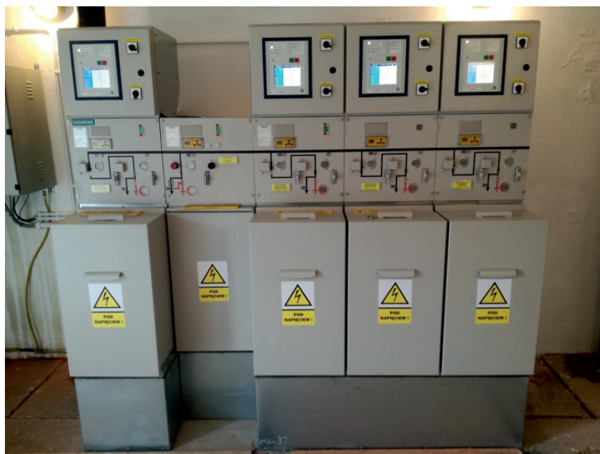
Rys. 6. Rozdzielnica z 1 polem transformatora i 4 polami liniowymi, sterowniki polowe SO-54SR-122 umieszczone w nadbudówkach każdego z pól liniowych
